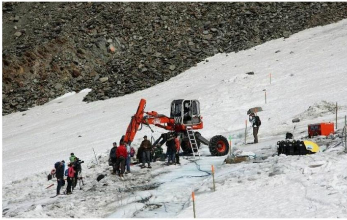
Une pelle-araignée de plus de 10 tonnes avait été montée sur le glacier de Tête Rousse en août 2010, afin de vidanger progressivement une poche d'eau de 65 000 m 3 .
